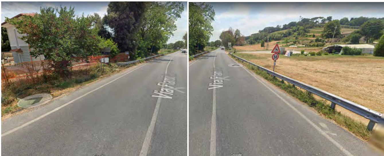
Figura 2-11 Via Flaminia nel tratto interessato, si osserva la mancanza di fossi di raccolta.
